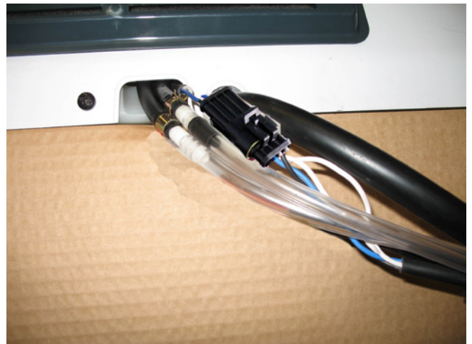
16b Particolare della connessione dell'insieme dei tubi con il Bycool.
